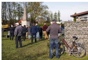
Demontaż sowieckiego obiektu propagandowego „wdzięczności Armii Czerwonej” - Grubczyce, 5 maja 2023/ FOT. M.Bujak IPN
